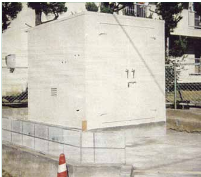
防音パネルユニット施工例
